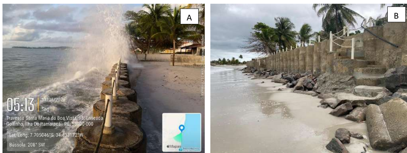
Figura 6: Foto registradas na Enseada dos Golfinho, na Ilha de Itamaracá -PE. A-Trecho da praia com muro de arrimo e pedras a fim de proteger os imóveis, durante a maré alta. B-Trecho da praia com muro de arrimo e pedras, durante a maré baixa.
