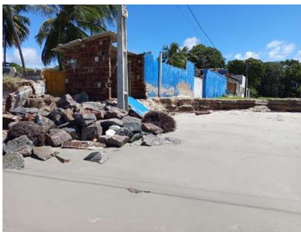
Figura 01 – Erosão significativa na praia do Âmbar com destruição do patrimônio público e privado.
